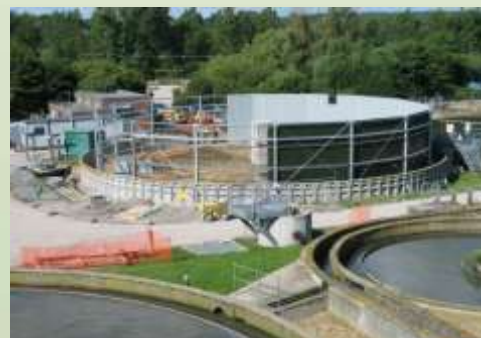
Złoże biologiczne o średnicy 25 m w budowie. Drewniany fundament służy jako pomost roboczy i miejsce składowania materiałów.
