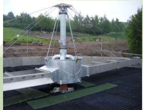
Dwuramienny zrasczacz HYCOVER w wersji rynnowej z napędem o zmiennej prędkości o wydajności 70 l/s na powierzchnię o średnicy 13.1 m. Złoże wstępne zawierające 430 m 3 wypełnienia o wysokości 3.6 m.
