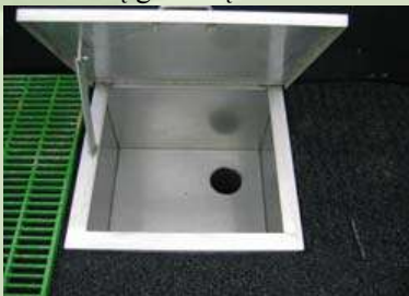
Zbiornik płuczkowy wykonany ze stali nierdzewnej zamontowany w sąsiedztwie otworu rewizyjnego
