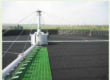
Dwuramienny zrasczacz o konstrukcji rurowej z napędem o zmiennej prędkości o wydajności 60 l/s zamontowany na oczyszczalni biologicznej HYRATE Polytower o średnicy 22.5m i wypełnieniu z tworzywa sztucznego o objętości 2430 m 3
